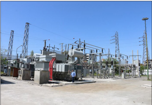
نیروگاه برق‌آبی گیلان در نزدیکی روستای کلاچای
